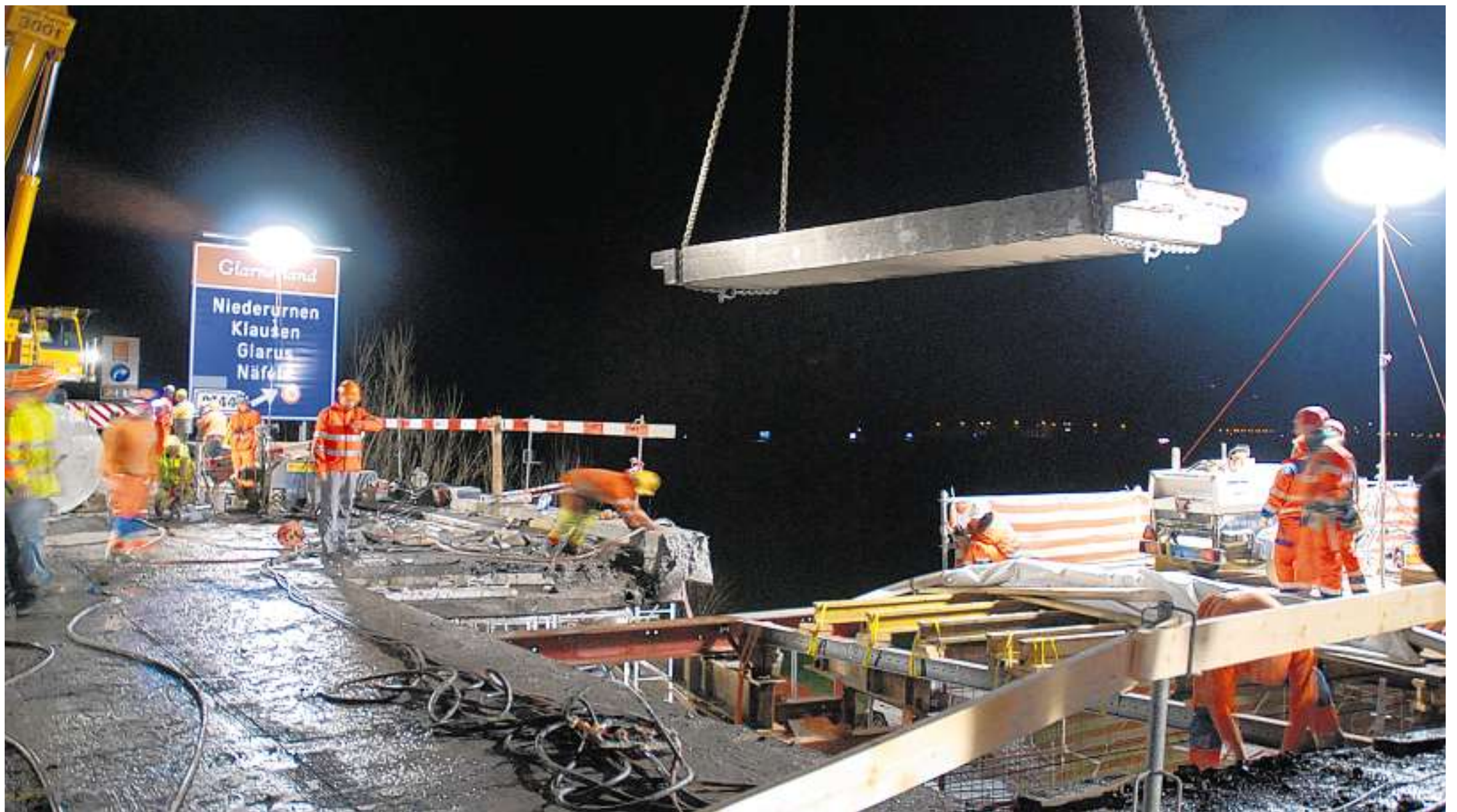
Hoch in den Lüften: Ein Teilstück der A3-Brücke bei Niederurnen wird mittels Pnekran entfernt.
