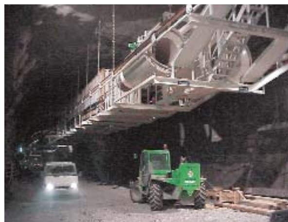
Heck der Vortriebsinstallation mit Luttenspeicher für Frischluft und Sprenggasabsaugung in der Startphase.
